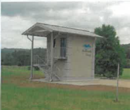
Vier Brunnen versorgen 30.000 Einwohner rund um die Uhr mit Trinkwasser.
