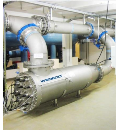
SYMBOL-FOTO einer UV-Anlage zur Trinkwasseraufbereitung
