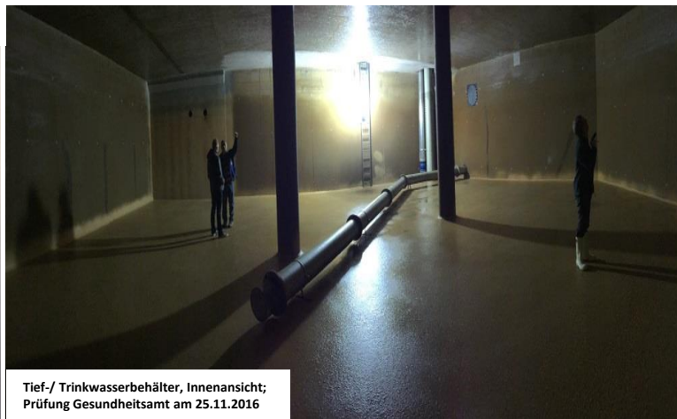
Entsauerungsanlage und Tiefbehälter
