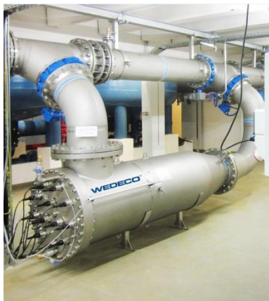
SYMBOL-FOTO einer UV-Anlage zur Trinkwasseraufbereitung
